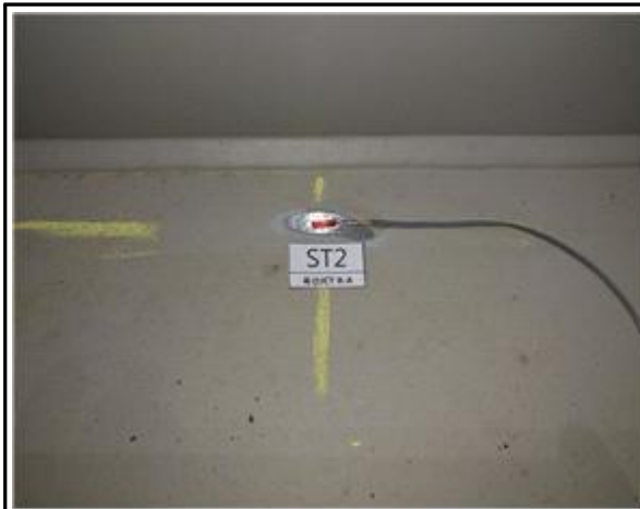
변형률계 설치 현황
