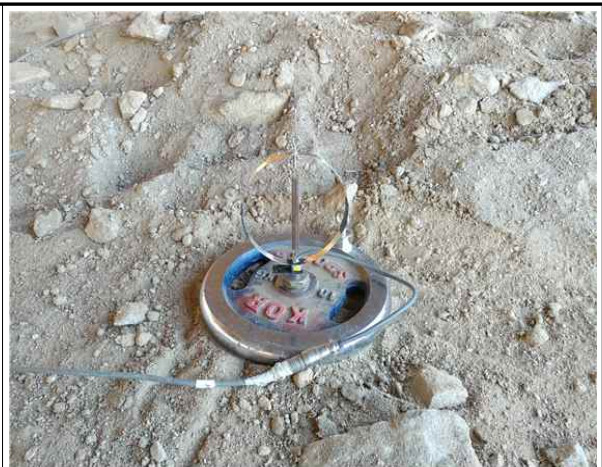
처짐계 설치 현황
